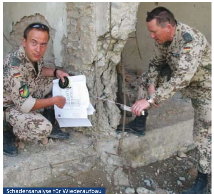
Schadensanalyse für Wiederaufbau
